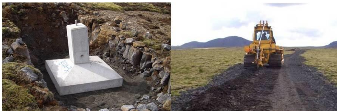
Mynd 4 Dæmigerð mynd af undirstöðu undir burðarmastur áður en fyllt er að henni og til hægri sést hvernig jarðskaut er plægt í vegslóð. Vegslóðin á myndinni er nokkuð dæmigerð.
